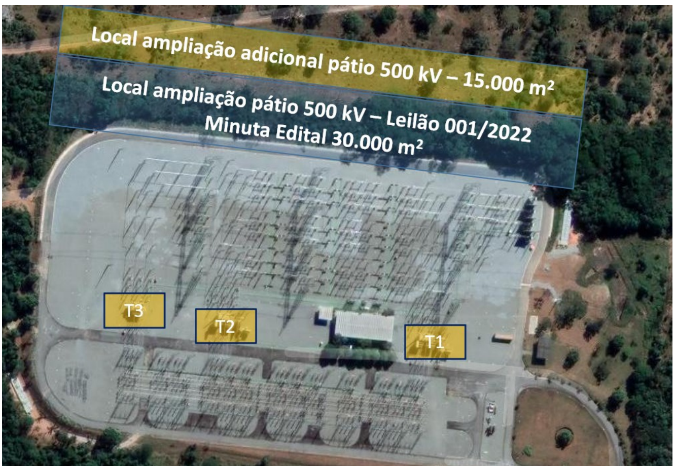
Figura 5-9 – Localização transformadores e áreas comprometidas na SE 500/138 kV São Gonçalo do Pará
